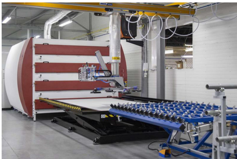
Rys. 4.4. Wygląd linii technologicznej.
