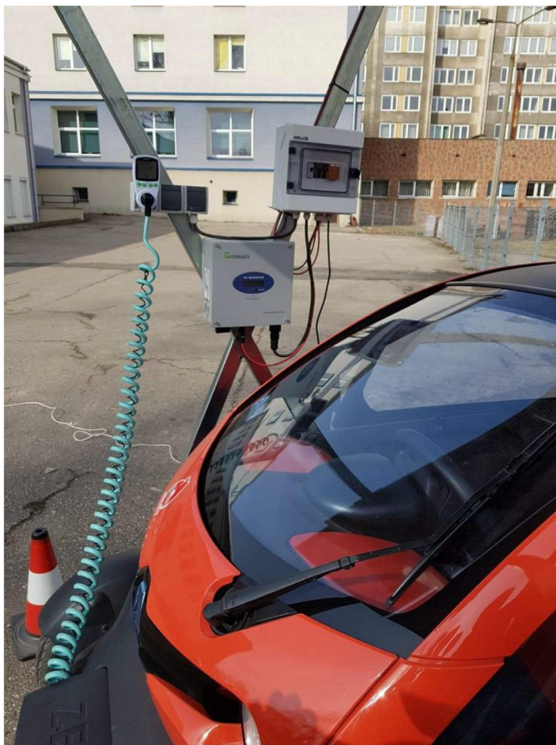
Rys. 4.16. Podłączenie pojazdu elektrycznego do carportu celem ładowania baterii
