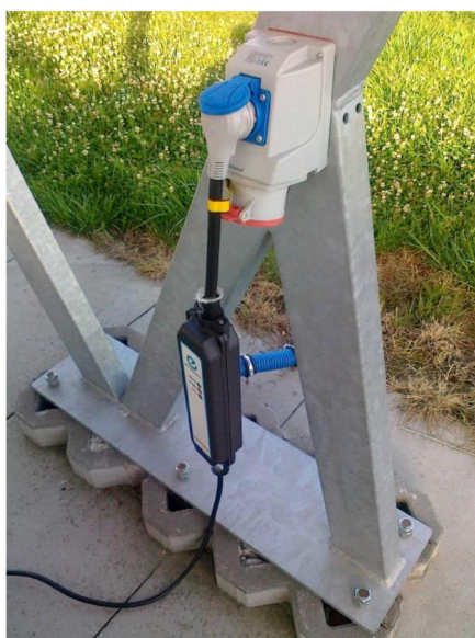
Rys. 2.32. Podłączenie przewodu do carportu
