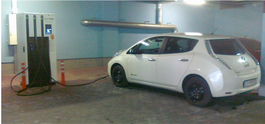
Rys. 2.38. Ładowarka sieci Greenway na parkingu podziemnym Artium Felicity w Lublinie
